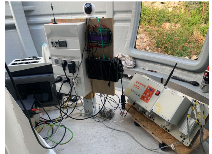
Contrôle électrique et monitorage météo et visuel Ordinateur « météo »
